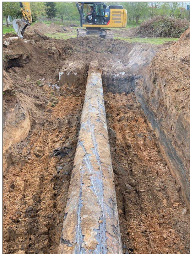
Abbildung 4: Rückbau Entwässerungsstrecke, weiter hinten ist jeweils rechts und links noch die Betonummantelung vorhanden (Quelle: C. Böhler, Datum der Aufnahme: 04.05.2021).
