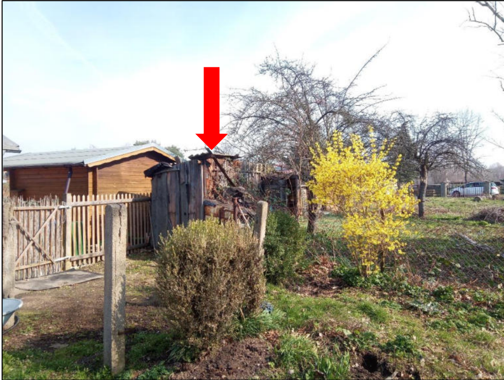
Bild 3: Eine ruinöse Gartenlaube aus Holz steht im Nordosten des Plangebietes (IB Hauffe GbR, März 2020).
