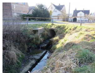
Bornshainer Bach Ist-Zustand
